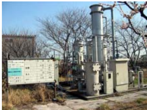
地下水浄化装置
