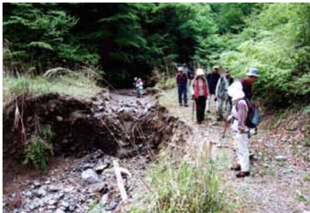
バラシマ林道の道床崩壊
